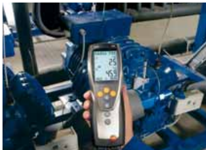
冷却プラントで複数箇所の温度を同時に計測
