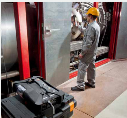
タービンの排ガス濃度測定
